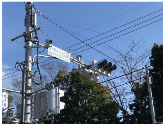
自動運転バスと連携する公道上に設置されたセンサ
